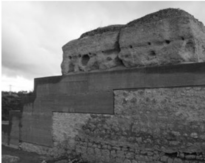
Figura 4: Componentes integrados a la murallas de Paderne, Portugal.
