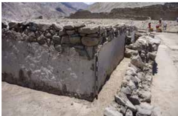
Foto 4. Esquina noroeste del primer momento constructivo del ushnu (muros E2-21 y E2-22), donde se aprecia el enlucido blanco de sus muros, en segundo plano a la derecha se puede apreciar la escalera de acceso, clausurada por el muro de ampliación de la plataforma
