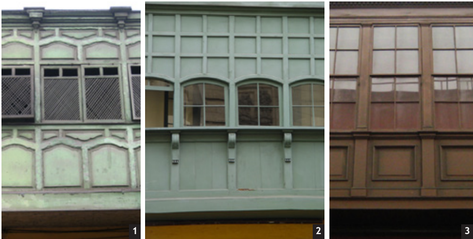
1. Detalle del balcón del s. XVIII del Jr. Huallaga 861. El sobreluz ha sido reemplazado por tableros rococó semejantes a los del antepecho. La ventana es de agalla con celosías.
